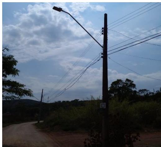
Figura 7.10 – Iluminação Pública Local.
