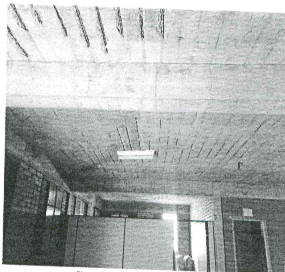
Figura 12: laje com ferragens aparente.
