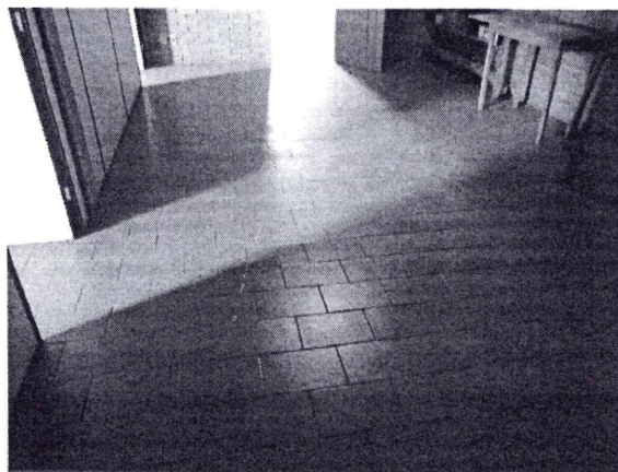
Figura 5: pisos ocas sofrendo deslocamento.
